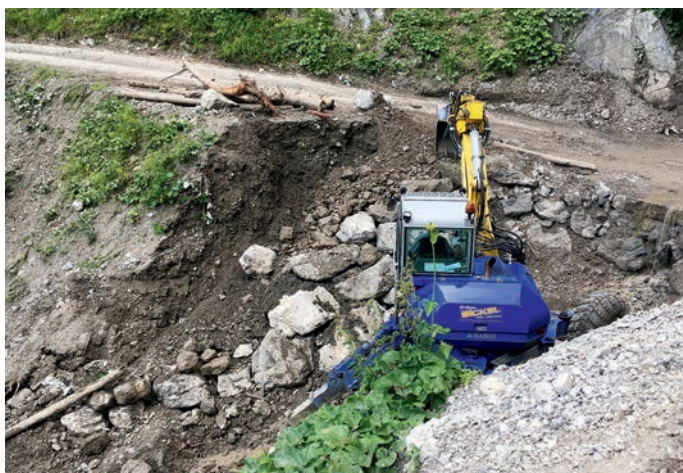
Unwetterschaden Oberlehenwaldweg Buchboden Juli 2018
