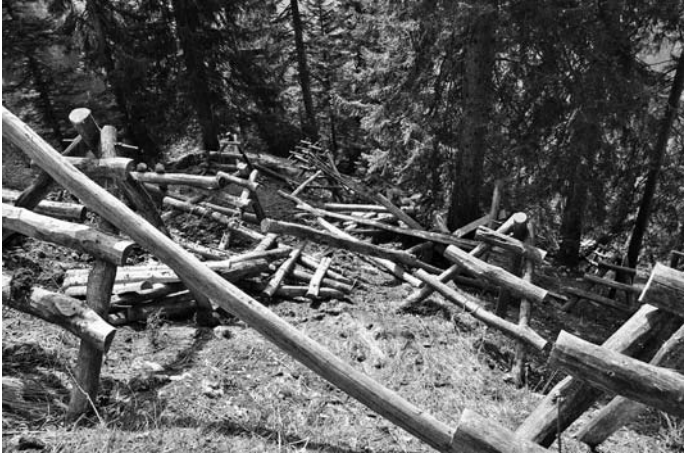
Zusammengebrochene Schneerechen und -böcke oberhalb des Hauswaldes auf der Oberalpe Grün - Frühjahr 2013
