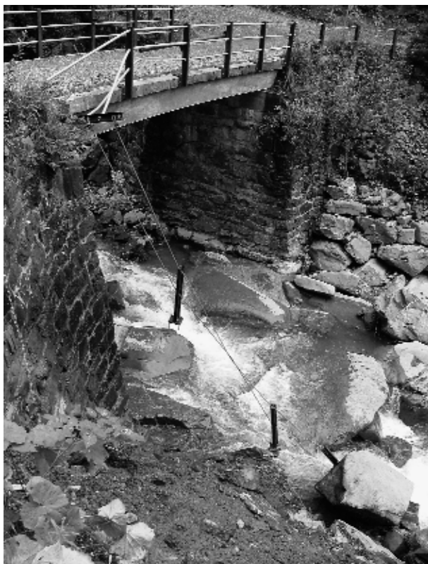
Garnitzabachbrücke nach dem Hochwasser vom 22. und 23. 8. 2005
